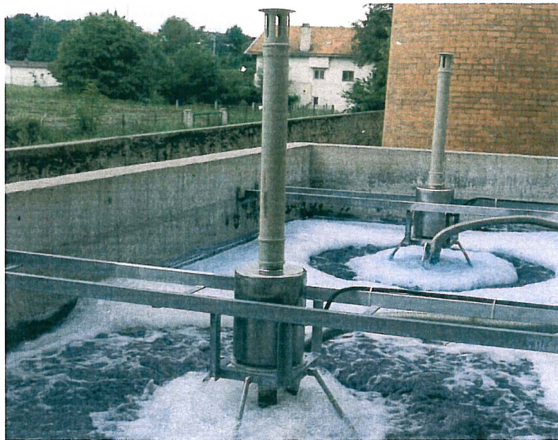
Neutralisation mit Rauchgas in einem Textilwerk CENTROX-Begaser im offenen Becken
