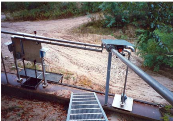
Neutralisation mit Rauchgas in einem Kalksandsteinwerk CENTROX-Begaser in einem liegenden Tank.
