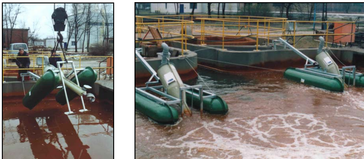
Abb. 3: Montage der Wendelbelüfter (links) und Wendelbelüfter im Einsatz (rechts) auf der Grubenwasserreinigungsanlage Schwarze Pumpe
